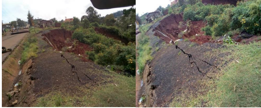
Figure 133: Effondrement de l'autoroute du boulevard de l'Archidiocèse à la suite des fortes pluies à Bafoussam le 19 novembre 2004
