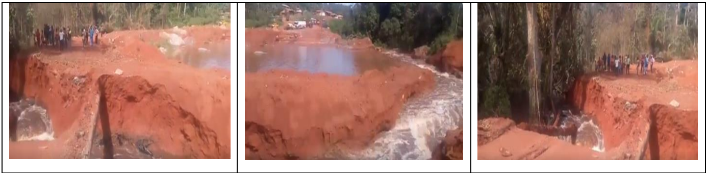
Figure 129 : De fortes pluies provoquent l'effondrement d'un pont à 5 heures du matin le 30/10/19 sur la route de Sangmelima-Djoum dans le village de Nkô, à 16 km de Djoum
