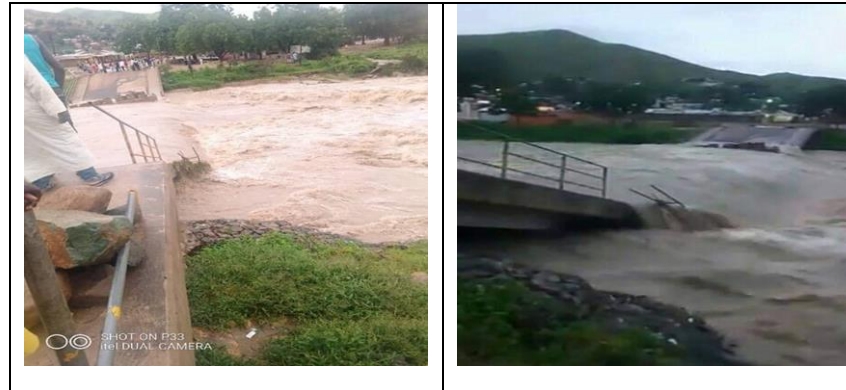
Figure 119: Le pont de Mizao s'est brisé à la suite de fortes inondations à Maroua le 28 août 2019
