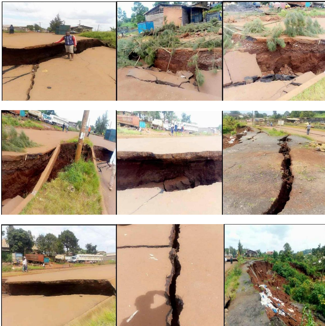
Figure 134 : L'autoroute du boulevard de l'Archidiocèse s'effondre continuellement à Bafoussam suite aux fortes pluies et aux orages du 19/11/05
